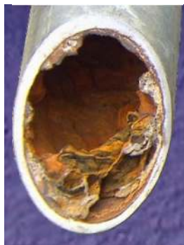
Abb.2: stark korrodiertes Rohr im Querschnitt.
