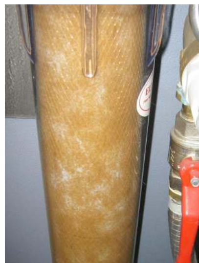
Abb.3: Rotbraune Vorfilter sind sichere Indikatoren für Schäden durch Korrosionsverschmutzung.
